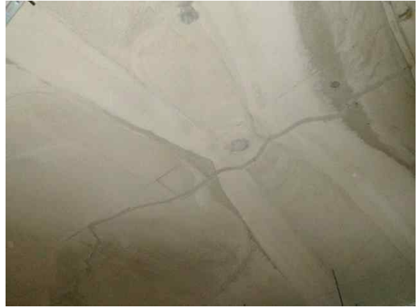
라이닝 S05 천단부 균열(Cw=0.3mm이상)-서울방향
