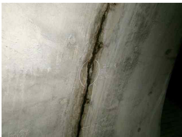
라이닝 S45 천단부 조인트부 들뜸-서울방향
