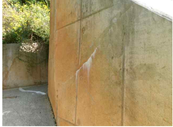
시점측 갭문 배수로 균열부 백태-서울방향
