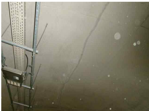
라이닝 S10 천단부 재균열(Cw=0.3mm미만)-서울방향
