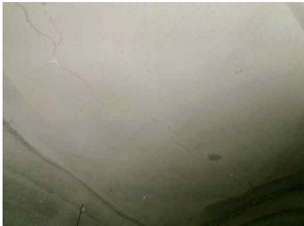
라이닝 S37 천단부 재균열 ( C_w=0.3\text{mm} 미만)-문산방향
