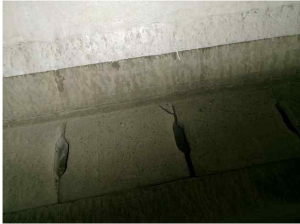
공동구 S20 뒹개파손-서울방향
