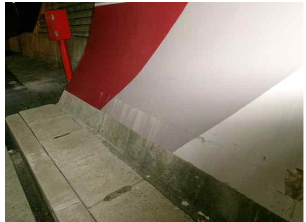
라이닝 S45 측벽부 하단 균열부 백태-문산방향
