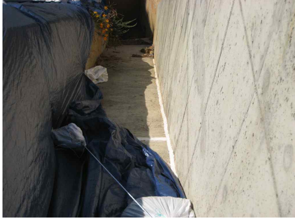
시점측 갭문 측면 토사유실 임시보수-문산방향
